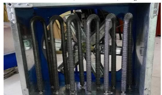
Hình 6. Lò đốt nhiệt bằng điện trở công suất 6 kW
